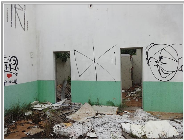
Foto nº 15 (📍): O “hall” dos banheiros que serviam ao restaurante está inviável pela deposição de materiais e alto grau de depreciação.
