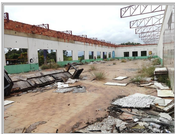
Foto nº 11 (↩): O interior do prédio do restaurante encontra-se totalmente depredado.
