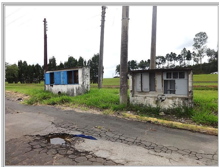
Foto nº 21 (📍): A propriedade é ainda dotada de casamata de medidores de energia, mas todos os equipamentos elétricos foram suprimidos.
