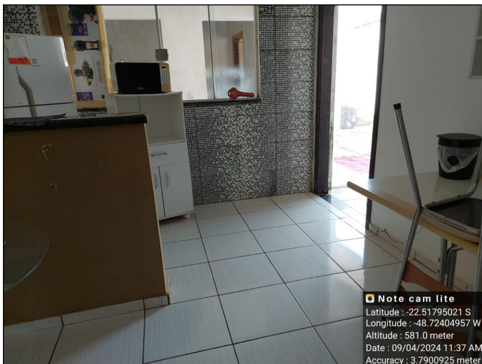
FOTO N° 06:- Detalhe parcial do interior da cozinha, onde podemos observar as suas principais características construtivas.
