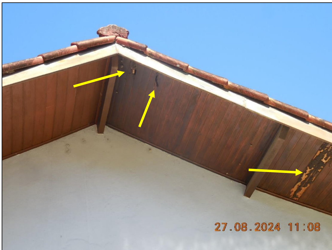
FOTOGRAFIA Nº 10: Detalhe dos danos no beira do telhado.
