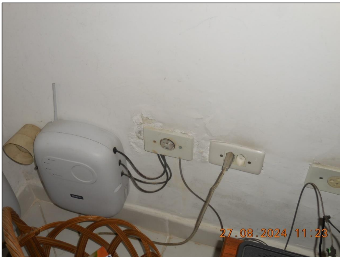
FOTOGRAFIA Nº 29: Detalhe das manchas de umidade no revestimento da alvenaria.
