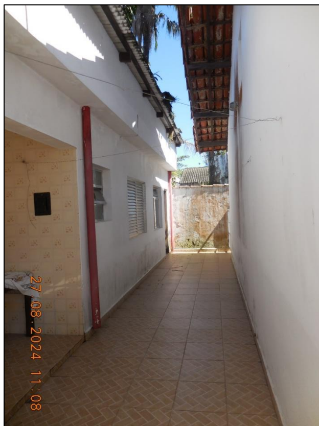
FOTOGRAFIA Nº 15: Vista geral do corredor lateral. Detalhe para as fissuras e manchas de umidade no revestimento das alvenarias.
