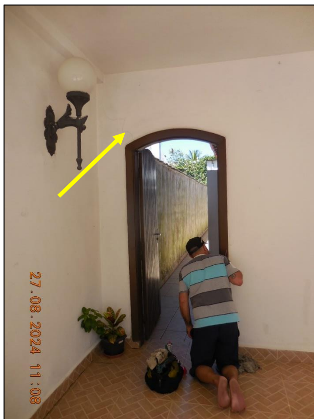
FOTOGRAFIA Nº 11: Detalhe das fissuras no revestimento da alvenaria.
