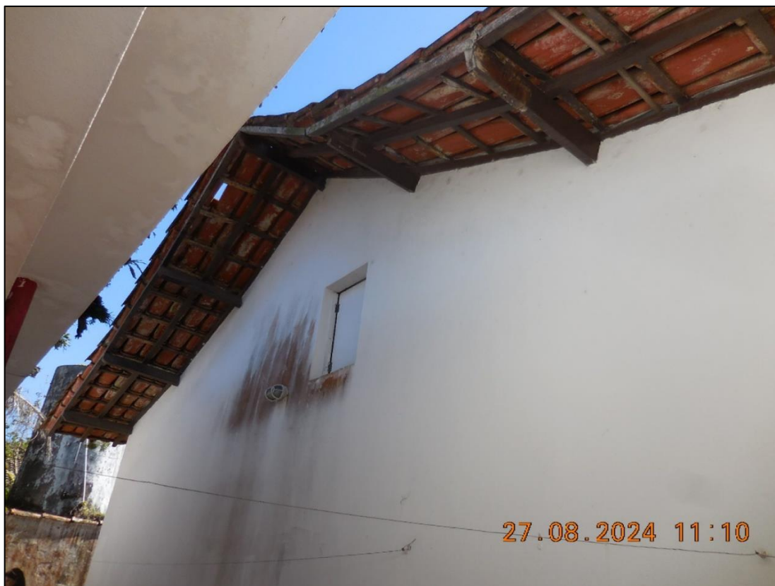
FOTOGRAFIA Nº 21: Detalhe dos danos e manchas de umidade no revestimento da alvenaria e no beiral do telhado.
