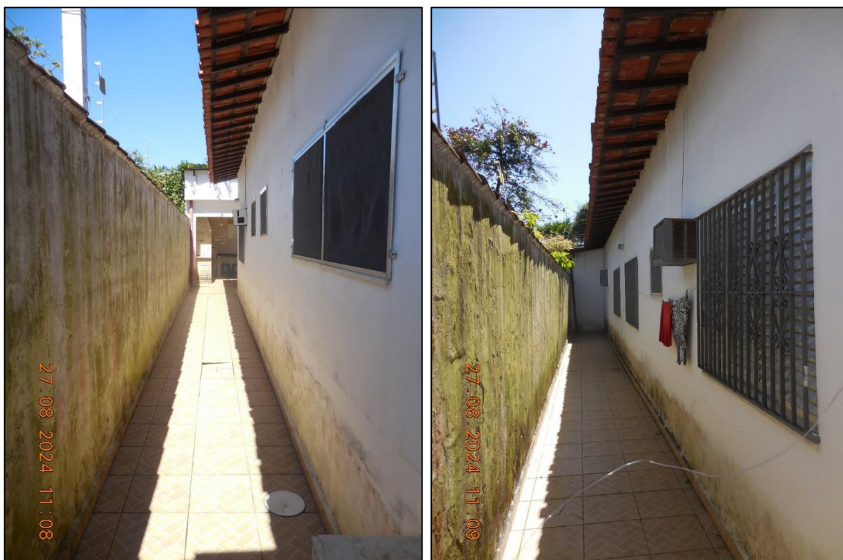
FOTOGRAFIAS Nº 12 E Nº 13: Vista geral do corredor lateral. Detalhe para as fissuras e manchas de umidade no revestimento das alvenarias.
