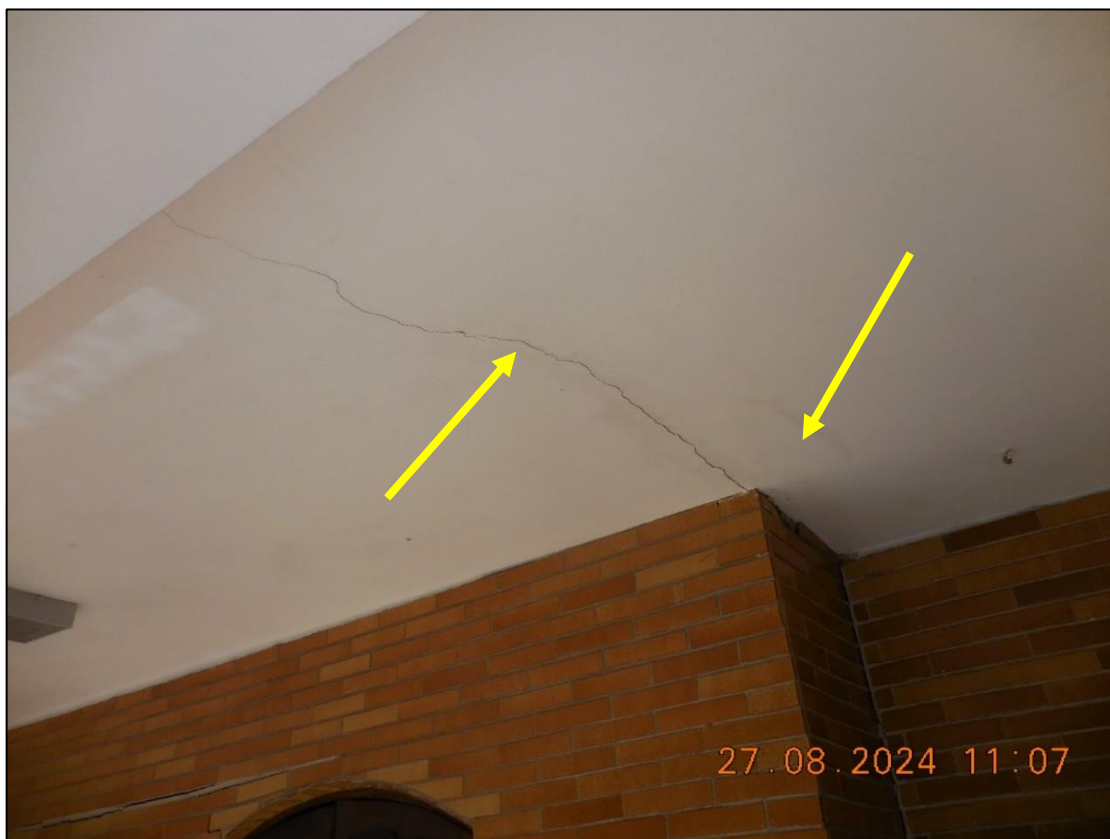
FOTOGRAFIA Nº 07: Detalhe das trincas e manchas de umidade no revestimento do forro.
