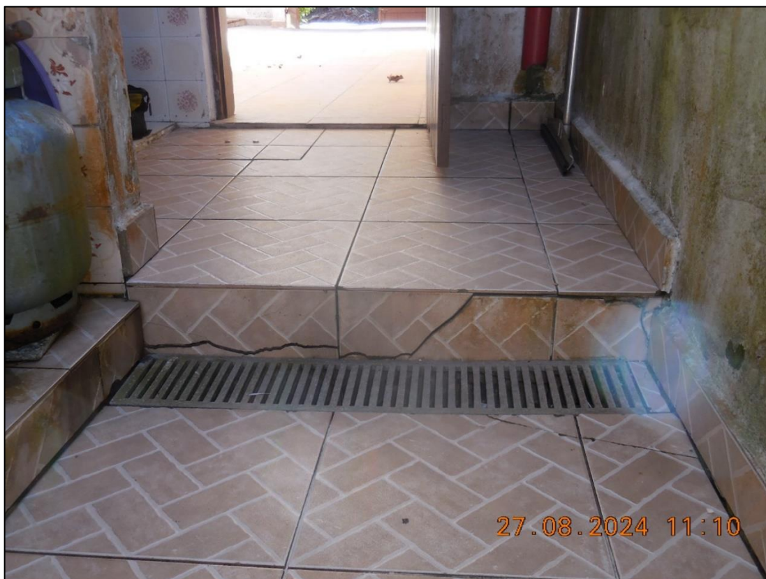
FOTOGRAFIA Nº 22: Detalhe das trincas no revestimento do piso.
