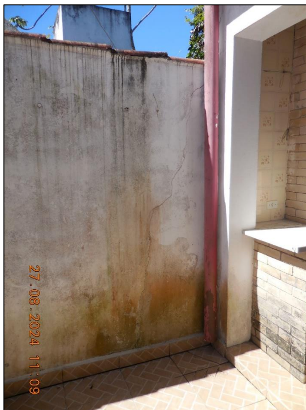
FOTOGRAFIA Nº 18: Detalhe das fissuras e manchas de umidade no revestimento da alvenaria.
