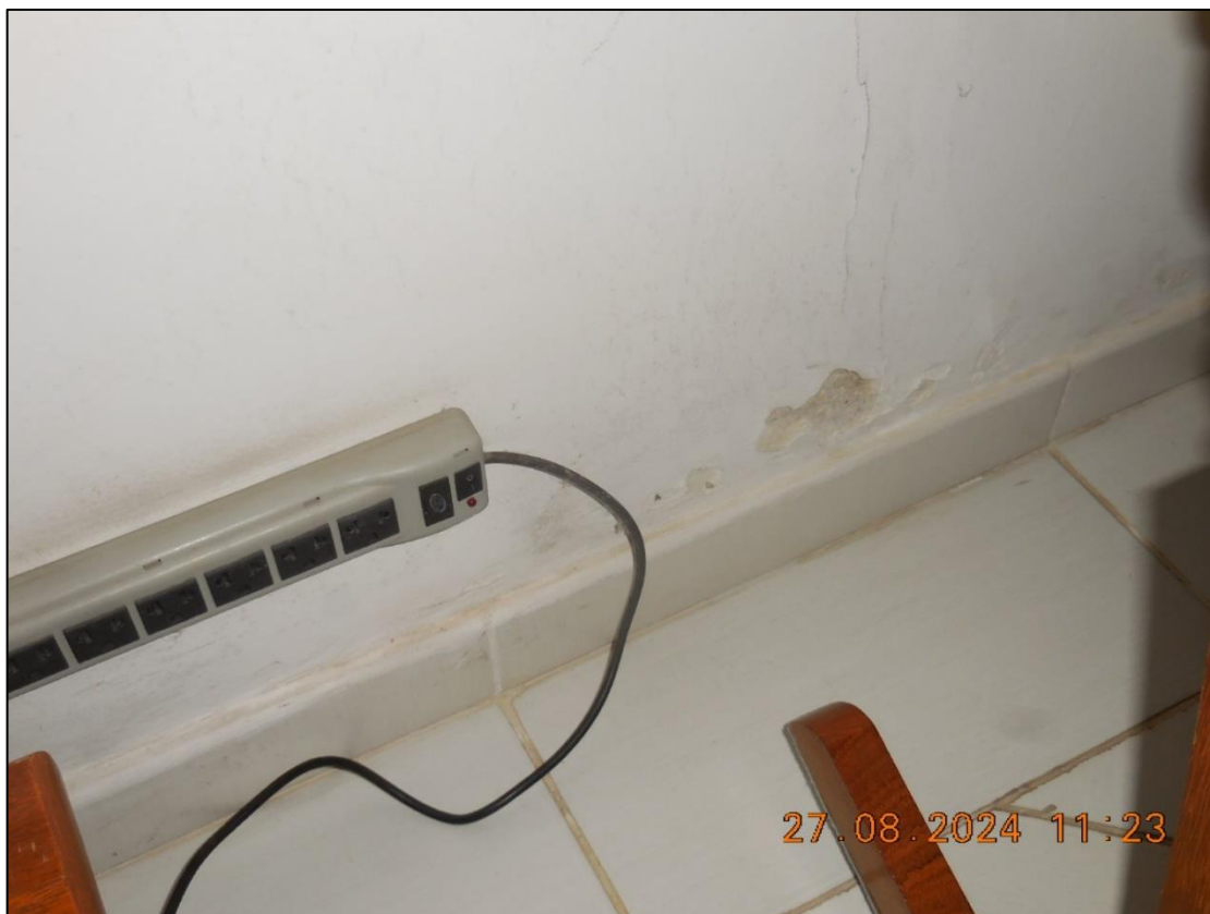
FOTOGRAFIA Nº 28: Detalhe das fissuras e o deslocamento do revestimento da alvenaria.
