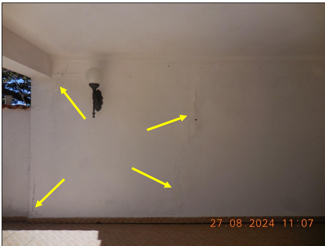
FOTOGRAFIA Nº 09: Detalhe das fissuras e manchas de umidade no revestimento da alvenaria - Garagem.
