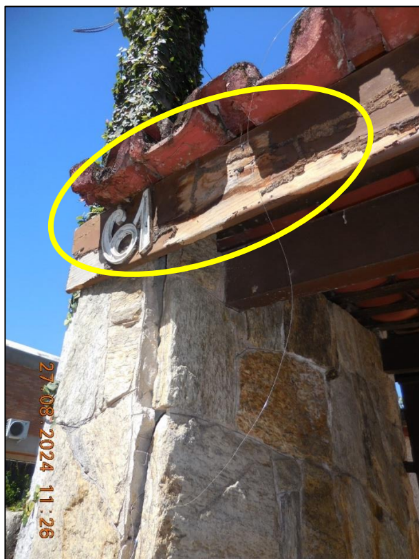
FOTOGRAFIA Nº 03: Detalhe da identificação do imóvel. Detalhe dos danos na madeira e telhas cerâmicas.
