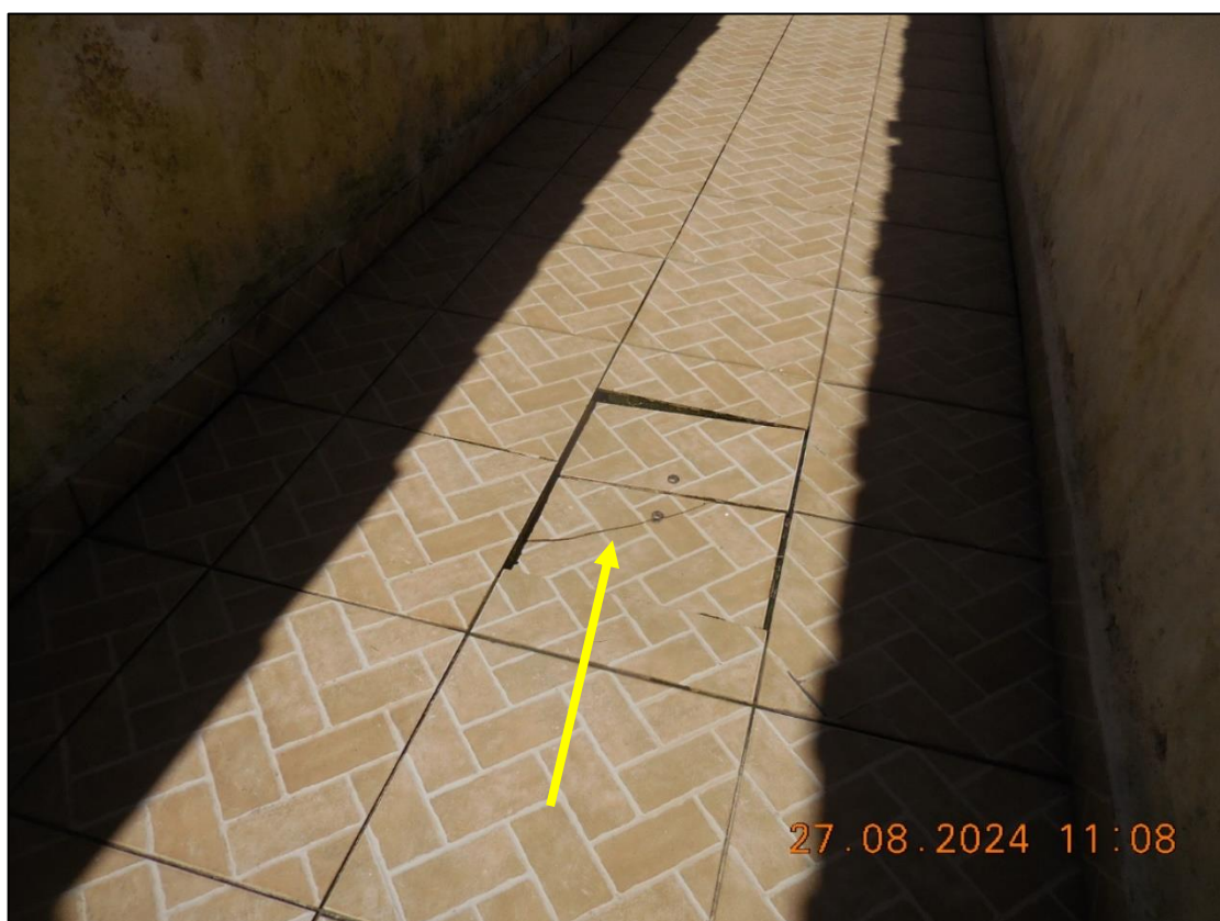
FOTOGRAFIA Nº 14: Detalhe das trincas no revestimento do piso.
