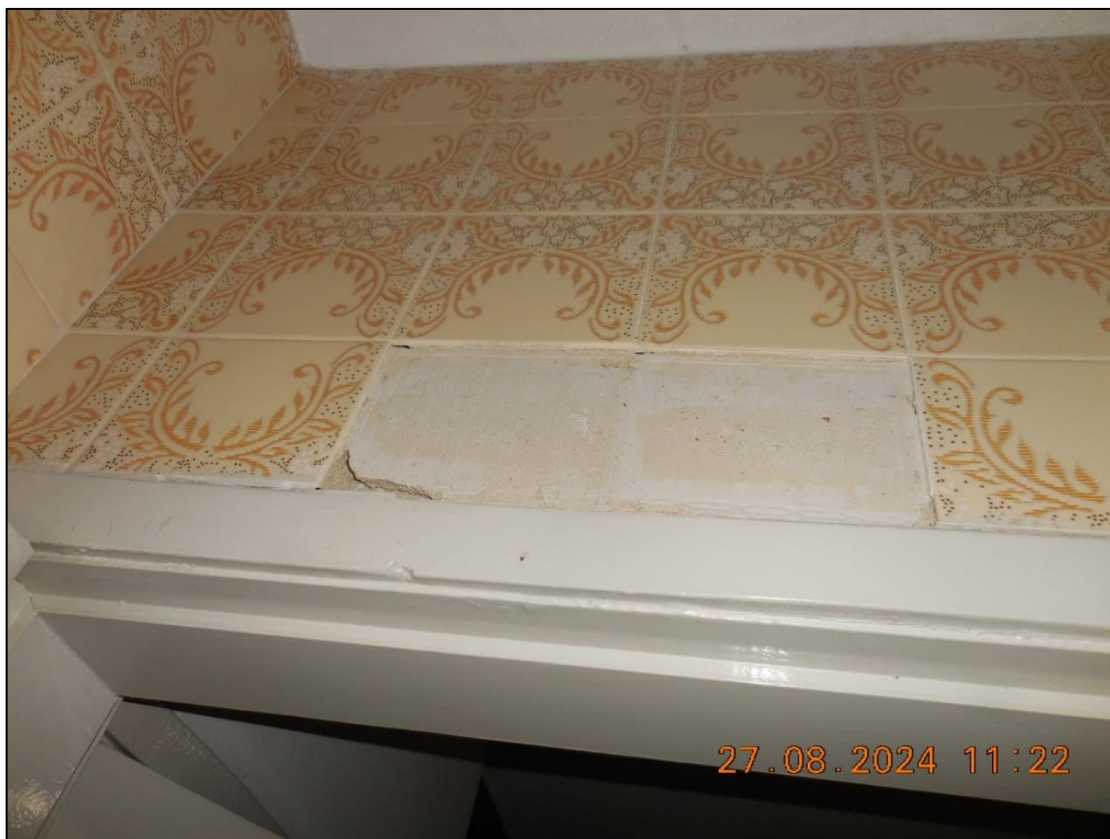
FOTOGRAFIA Nº 39: Detalhe do deslocamento do revestimento da alvenaria.
