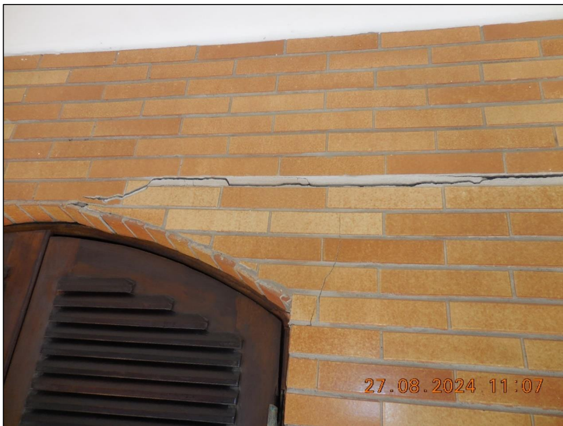
FOTOGRAFIA Nº 08: Detalhe das trincas no revestimento da alvenaria da fachada.
