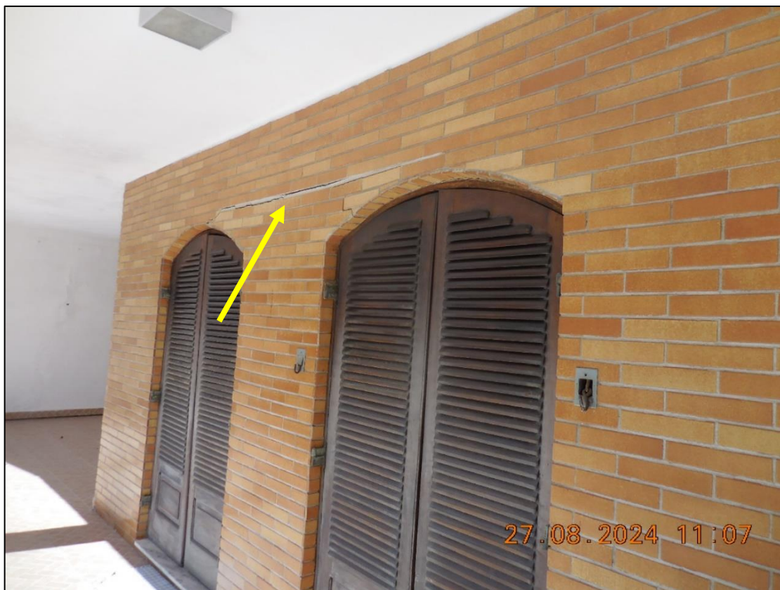
FOTOGRAFIA Nº 06: Detalhe das trincas no revestimento da alvenaria da fachada.
