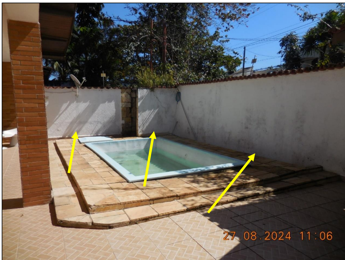
FOTOGRAFIA Nº 05: Vista geral da área da piscina. Detalhe das trincas e manchas de umidade no revestimento da alvenaria.
