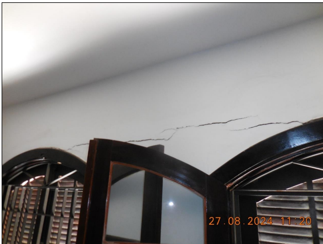
FOTOGRAFIA Nº 26: Detalhe das trincas no revestimento da alvenaria.
