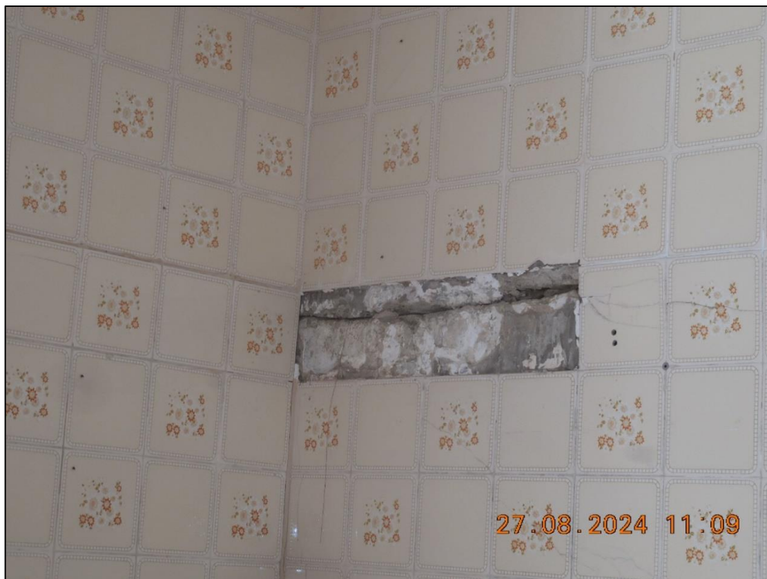
FOTOGRAFIA Nº 19: Detalhe do deslocamento do revestimento da alvenaria.
