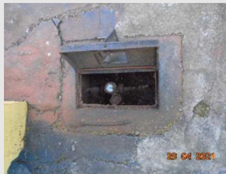
Abrigo, Cavalete e Hidrômetro
